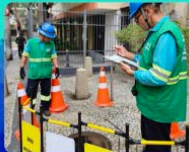
Fiscalização e Inspeção Manual de Rede
