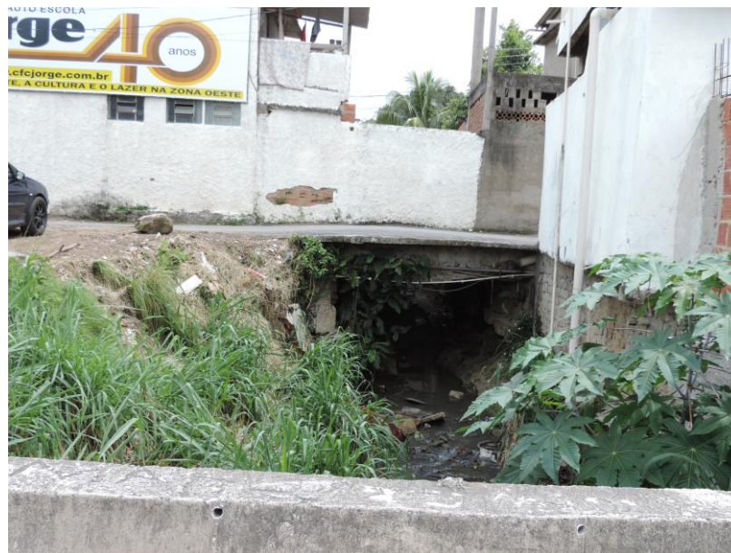
Figura 32 – Foto da parte baixa do Rio Cantagalo (Campo Grande) a montante do trecho que foi canalizado no ParkShopping Campo Grande, mostrando a condição de má qualidade do rio. Foto de Vladimir da Franca Fernandes.
