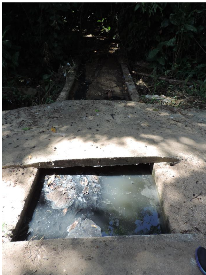
Figura 30 – Foto da parte alta do braço sul do Rio Cantagalo (Campo Grande) no Centro Ecológico Ana Gonzaga, após passar pela Favela Caminho do Morro, mostrando canalização do rio com assoreamento e lançamento de esgoto. Foto de Vladimir da Franca Fernandes.
